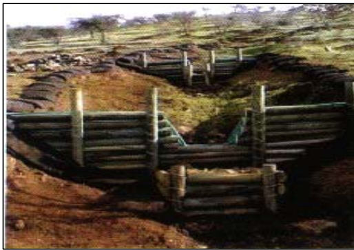
Fig 11 Dique de Postes: obra para el control de cárcavas y de cursos de agua secundarios, generalmente temporales, tales como arroyos y quebradas, que actúa por resistencia mecánica.
