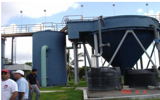
Fig. 16: Planta municipal de tratamiento de efluentes cloacales
