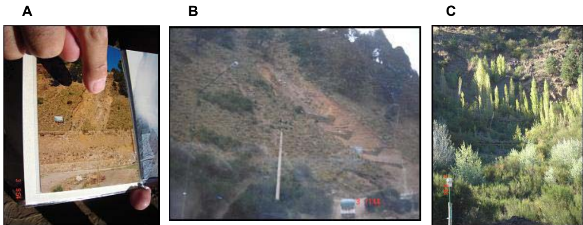
Fig 13: Etapas en la recuperación del suelo y forestación de la ladera. A) Pérdida de suelo, B) Obras de recuperación, C) suelo y vegetación recuperados. Sitio Demostrativo Lago Lacar. Programa Regional de Ecohidrología para América Latina y el Caribe de la UNESCO- Pcia Neuquén- Argentina.
